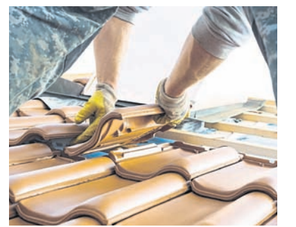
Dach decken: ja. Altdächer abreißen: nein, sagt Jens-Norbert Schmidt. Foto: Katharina Täubl
